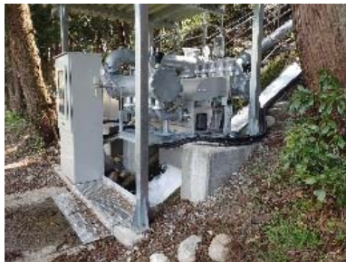
水車及び流量調整盤外観
