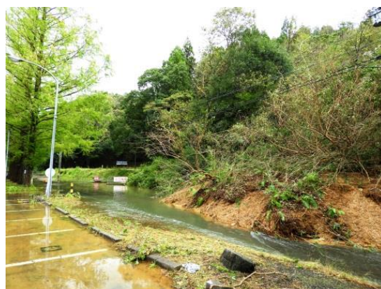
台風21号による土砂崩れ（第3駐車場出口付近） （2017年10月23日撮影）
